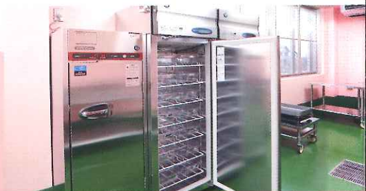
器具消毒保管庫・検食用冷凍庫
