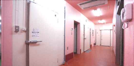
冷凍室・冷蔵室
